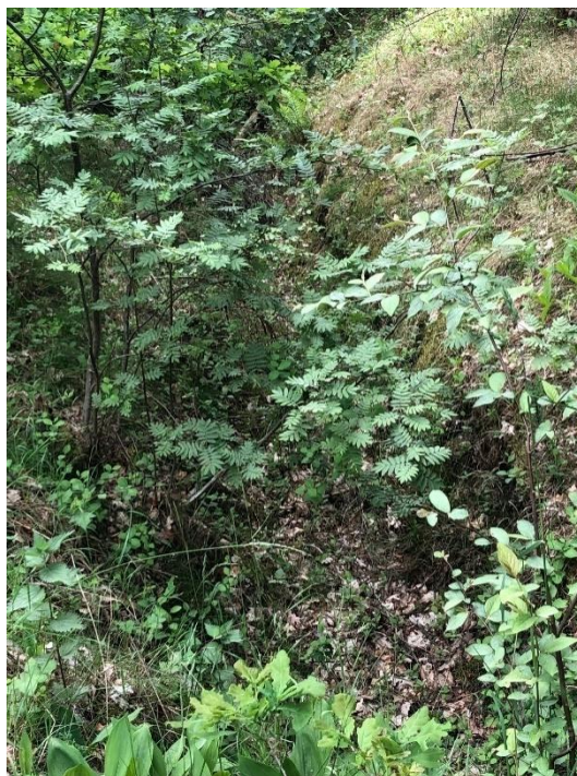
Dræningsgrøft – disse er karakteristiske for store dele af området. Nogle steder er dræningsgrøfterne meget tilgroede som på billedet.
